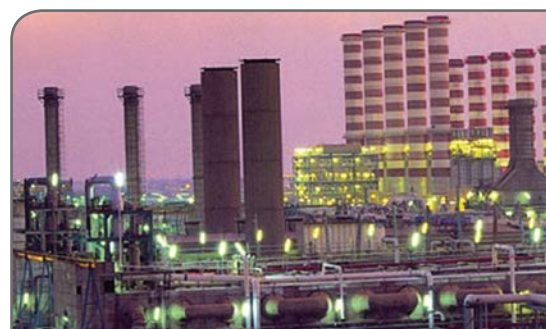
Lng / Chemical Plants
